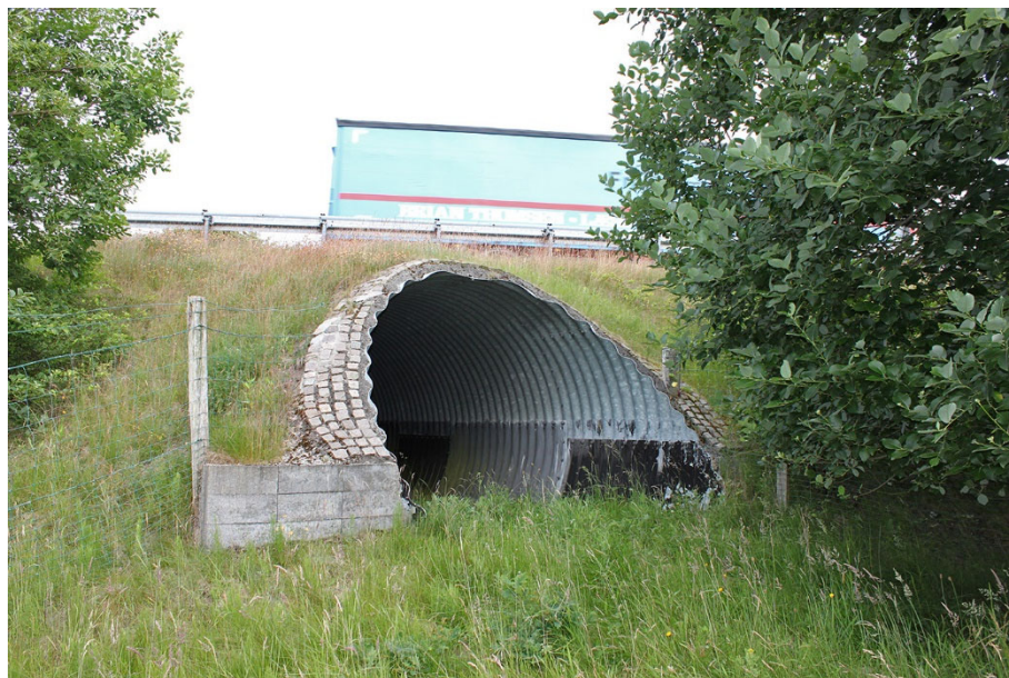
Figur B1.9. Underføringen ved Sulbæk er et stort rør, der er ført gennem en vejdæmning.
