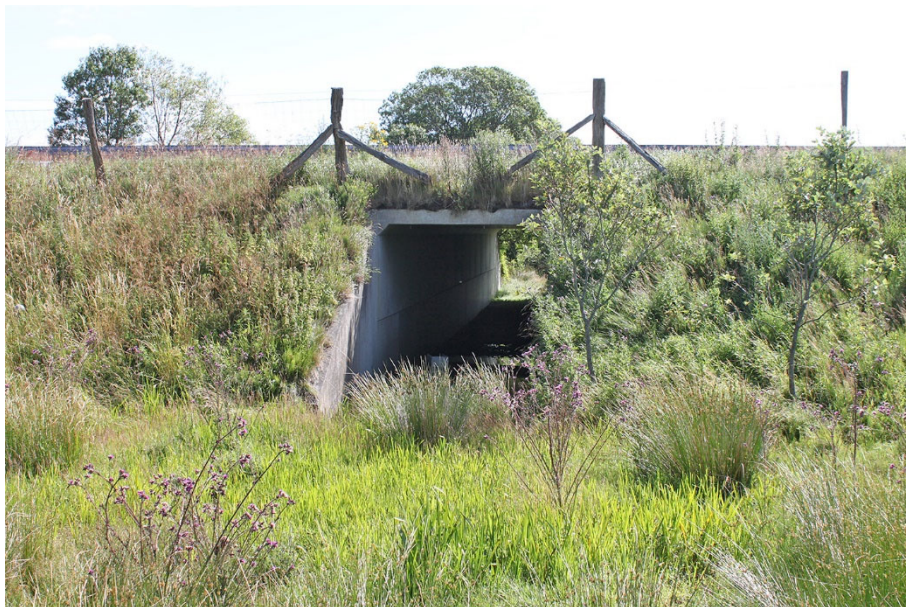
Figur B1.13. Underføringen ved Vestbjerg er en smal firkantet tunnel. Mod vest står der permanent vand i åbningen af underføringen og i afgravningen foran passagen.
