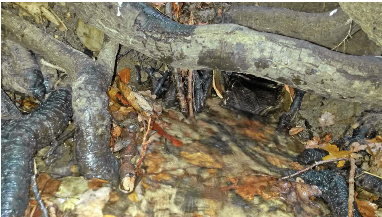
Figur 34. Udløb med sammenskredet lerrør under rødder. Kan ikke måles.
