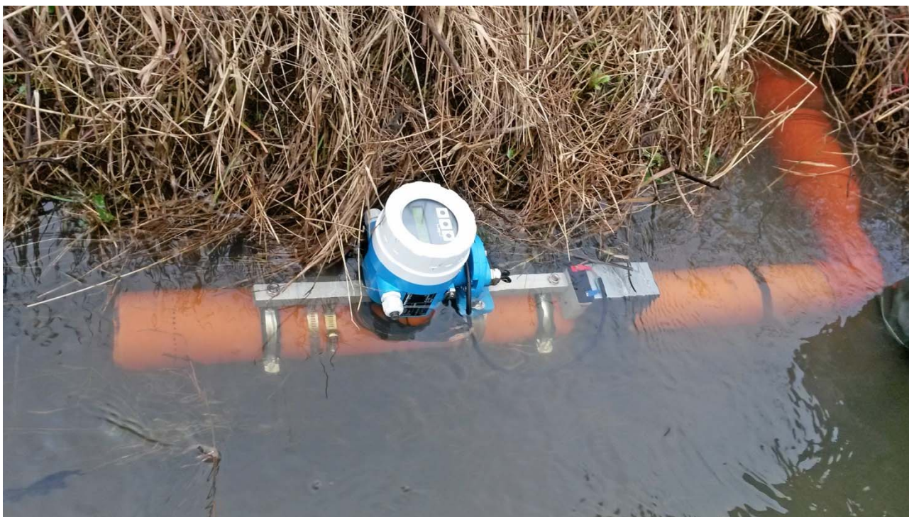
Figur 35. Måling med stor flowmåler med afbøjning i et lille vandløb og med dykket drænudløb.
